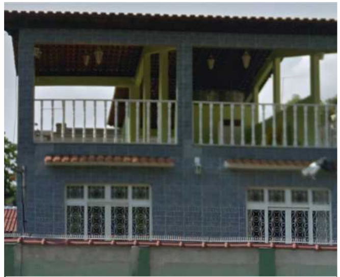
Revestimento cerâmico com tons escuros e paginação errada.
