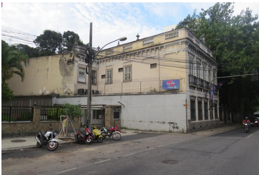
Figura 46: Coexistência conflituosa entre os imóveis de nº 308 e 314
