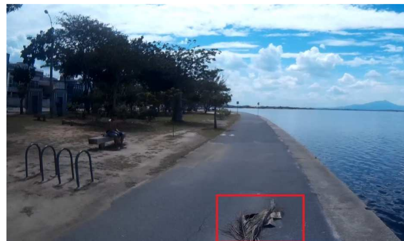
Figura 29: Pavimentação da faixa compartilhada no Parque do Moneró, apresentando um buraco na pista.
