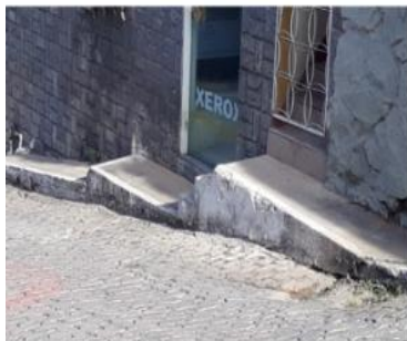
Falta de nivelamento entre as calçadas
